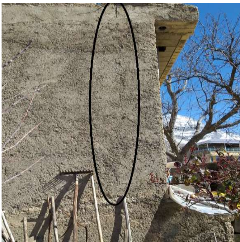
ایجاد ترک در ناحیه هشت گیری دیوار با شناژ قائم
