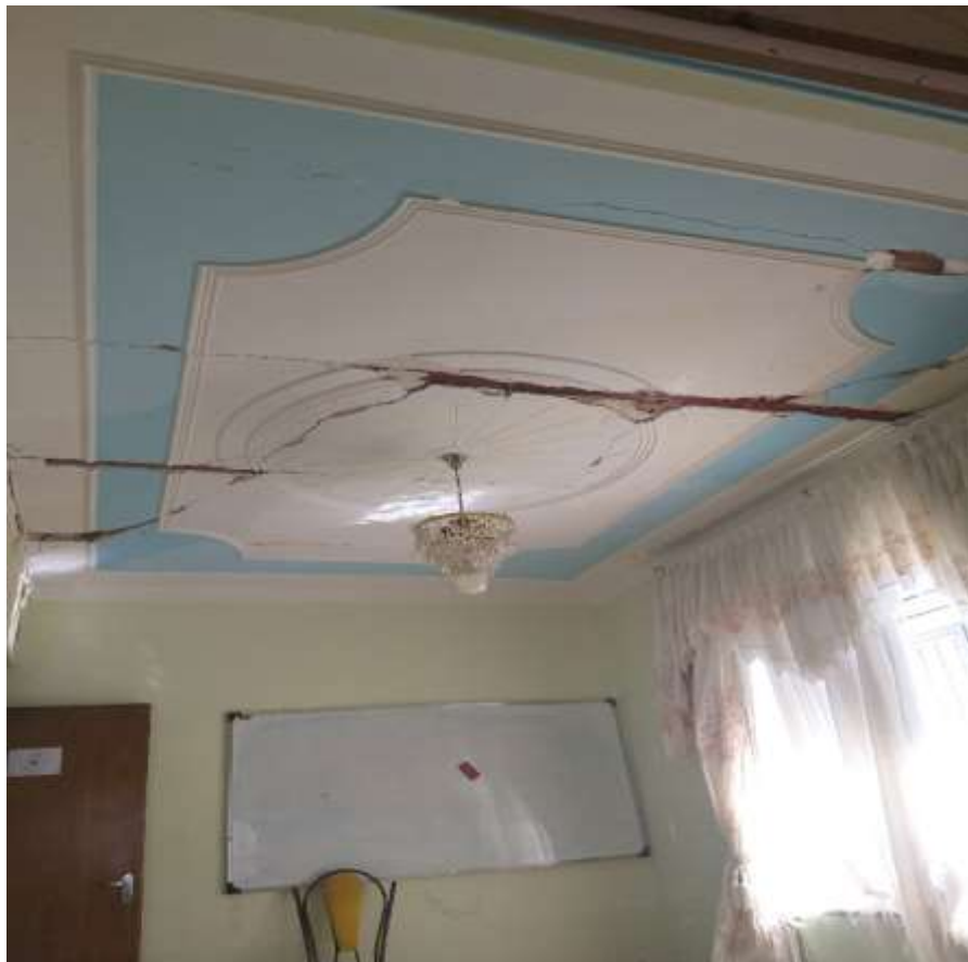
خرابی سقف طاق ضربی در زلزله سی سخت
