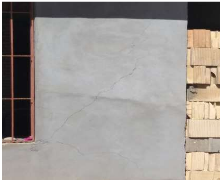
ایجاد ترک در سازه بنایی بخاطر عدم رعایت ضوابط بازشو
