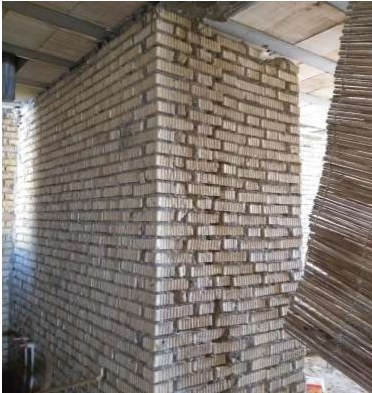
عدم اجرای کلاف در محل تقاطع دو دیوار
