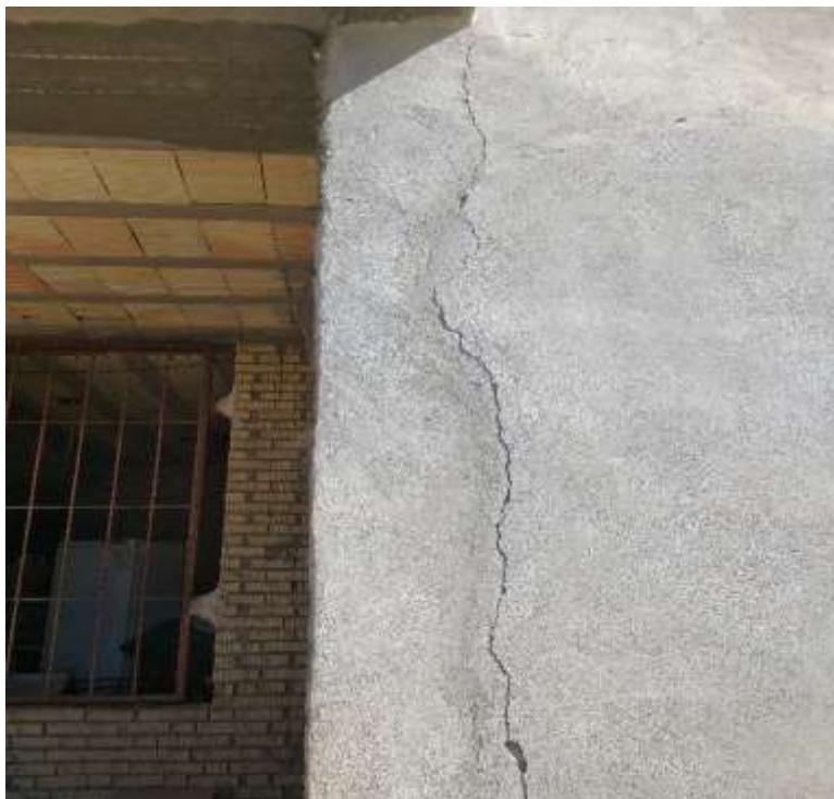
ایجاد ترک در ناحیه هشت گیری دیوار با شناژ قائم
