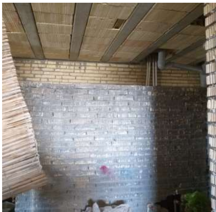
ریزش دیوار سازه بنایی بخاطر عدم تامین مهار مناسب برای دیوار
