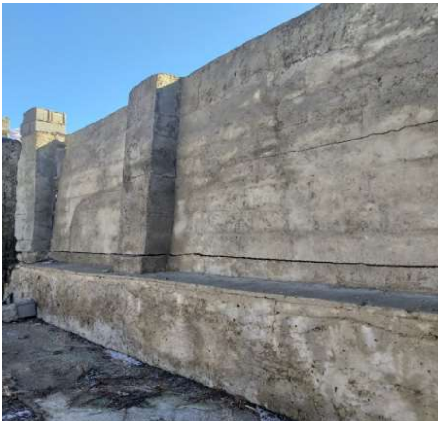
شکست خمشی دیوار محوطه در زلزله سی سخت
